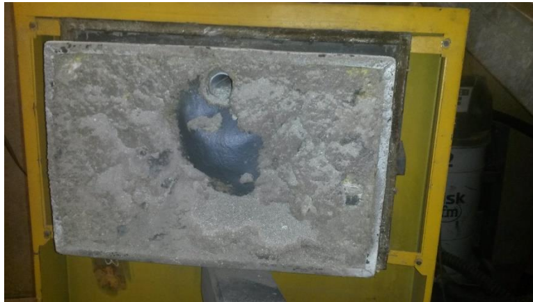
Photo 1 : Réfractaire endommagé sur la porte chaudière
