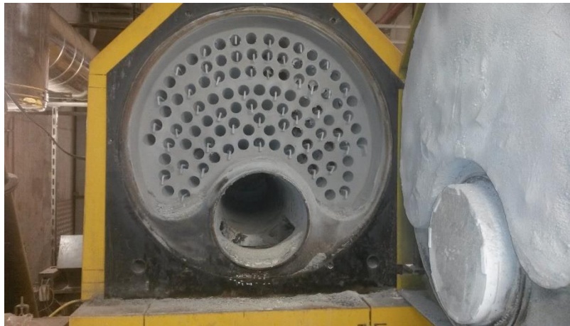
Photo 3 : Turbulateurs manquants dans les tubes de fumées
