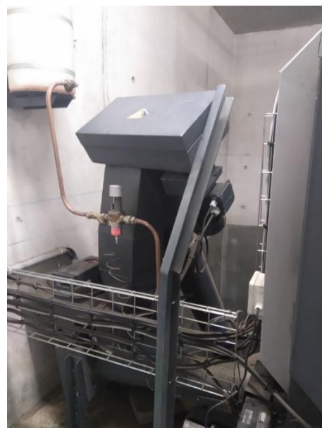
Photo 3 : Vis de transfert à 45° d'inclinaison qui remonte le bois du silo vers la chaudière
